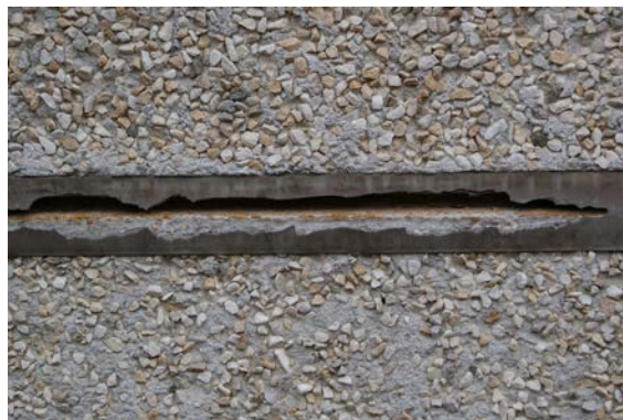
Fugen mit beschädigter Gummiabdichtung
